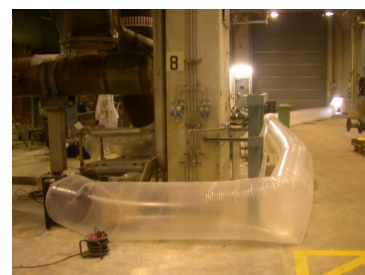
Kanaler för utsug av styrenångor vid arbete med hårdplaster
